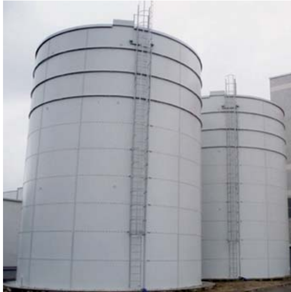
Rysunek 3.27. Cylindryczny zbiornik przeciwpożarowy [w3]
